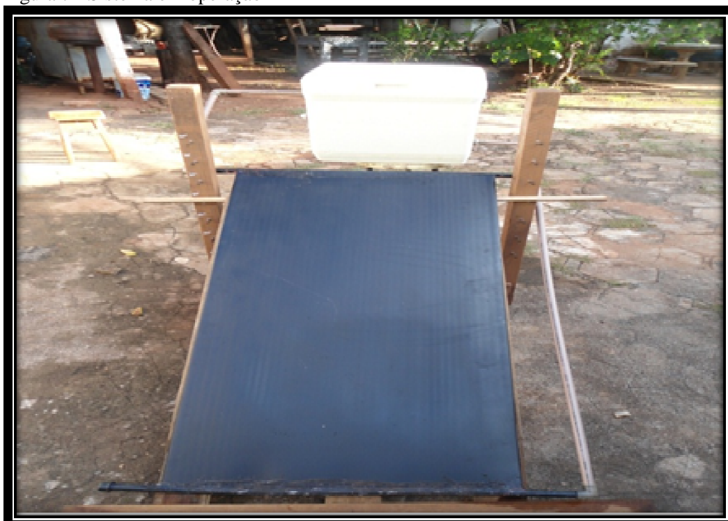
Figura 7 - Sistema em operação
