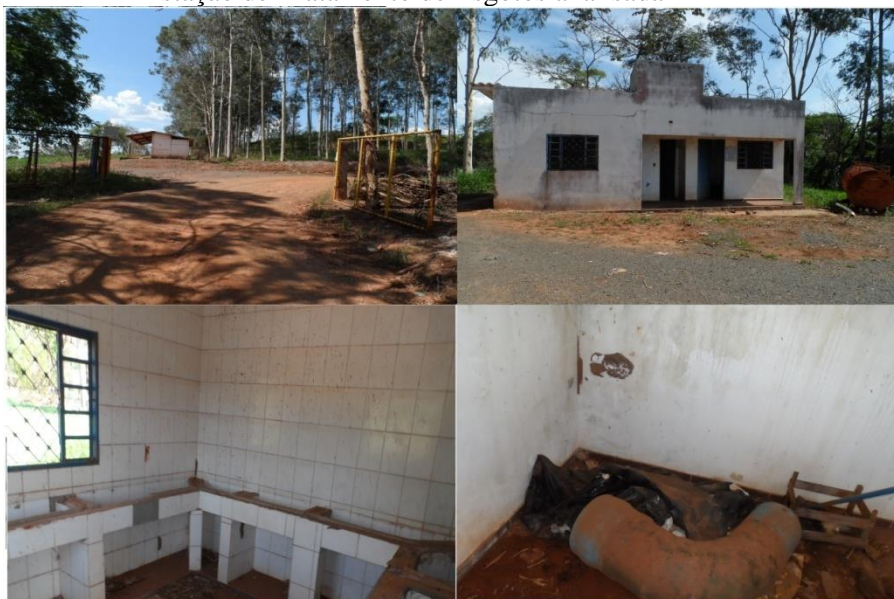
Figura 2 - Entrada com portões abertos e laboratórios abandonados da Estação de Tratamento de Esgotos analisada
