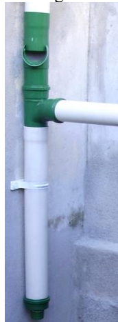
Figura 5 – Filtro autolimpante instalado no tubo de queda d'água
