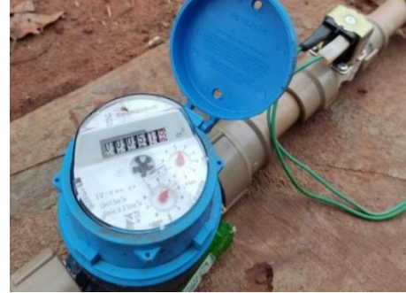
Figura 22 – Hidrômetro utilizado no fim da irrigação autônoma indicando 5180 litros.
