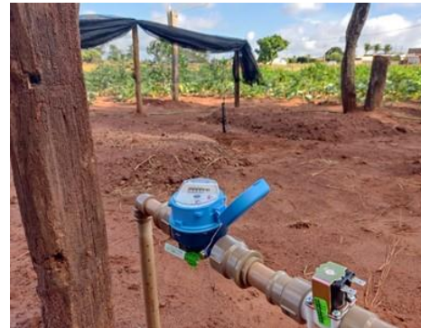
Figura 15 - Hidrômetro e válvula solenoide instalados
