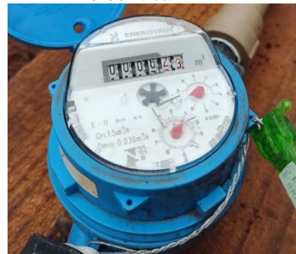
Figura 24 –Hidrômetro utilizado no fim da irrigação manual indicando 6230 litros.
