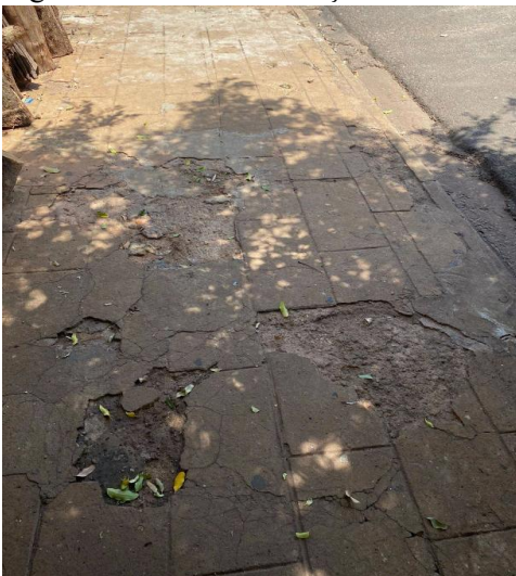
Figura 19 - Buraco na calçada
