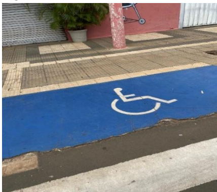
Figura 9 - Obstáculo na calçada
