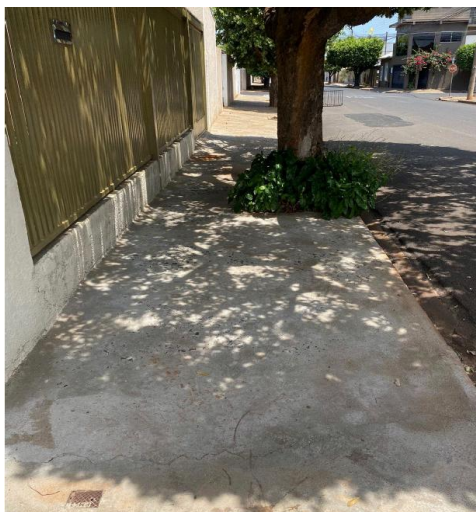
Figura 17 - Obstáculo na calçada
