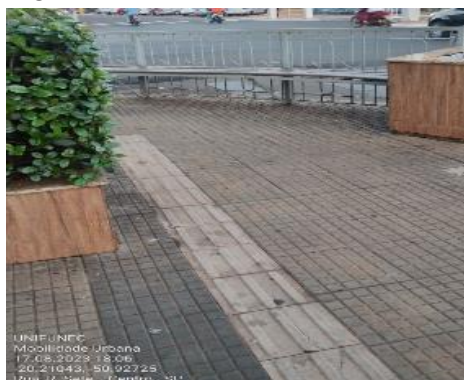
Figura 10 - Obstáculo na calçada
